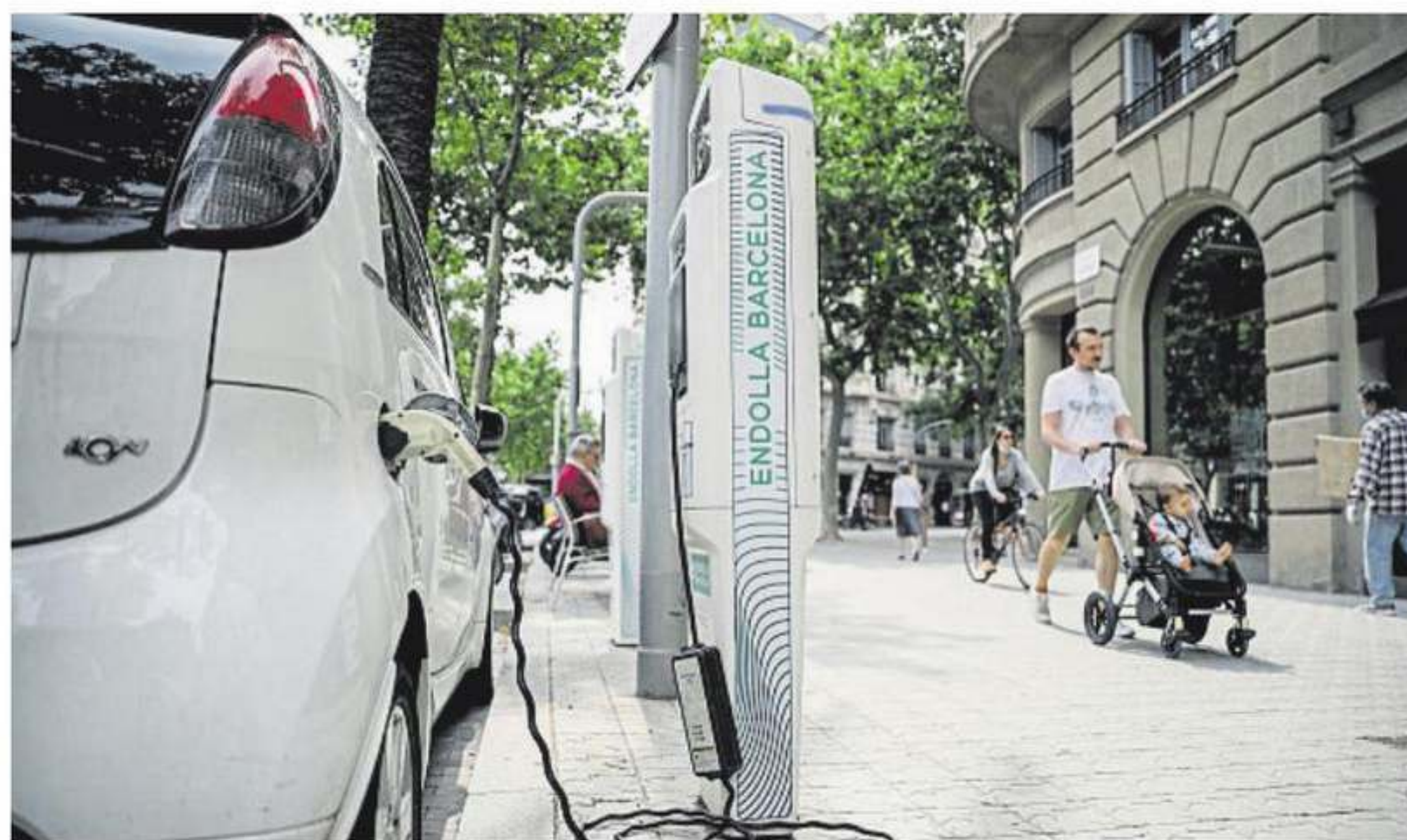
Punto de carga de coche eléctrico en el centro de Barcelona
